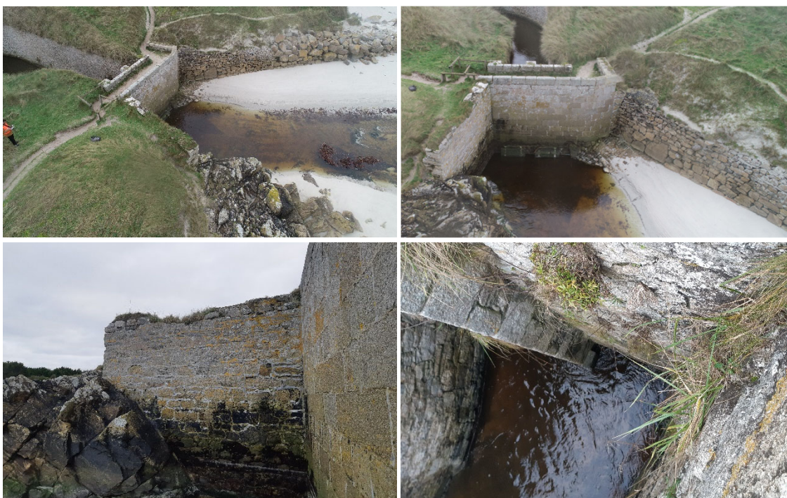
Figure 8. Clichés de l'exutoire de l'Alanan et de l'ouvrage maçonné et observation de quelques désordres.
